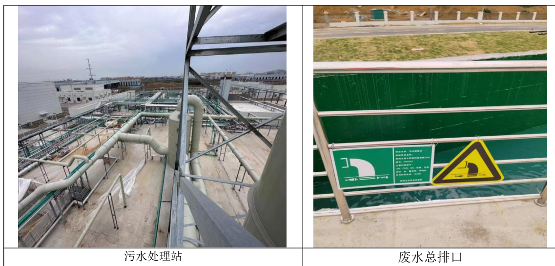
图 4-1 废水处理设施相关实物图
