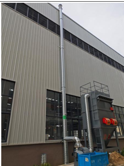
排气筒 DA001、布袋除尘器
