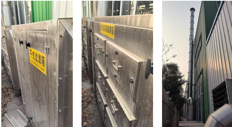
废气处理设施、DA001 排气筒
