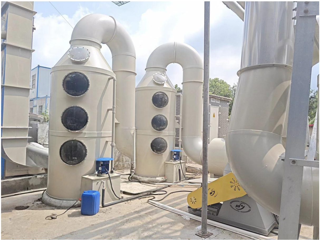
车间内收集废气、生产废气共同通过的喷淋塔
