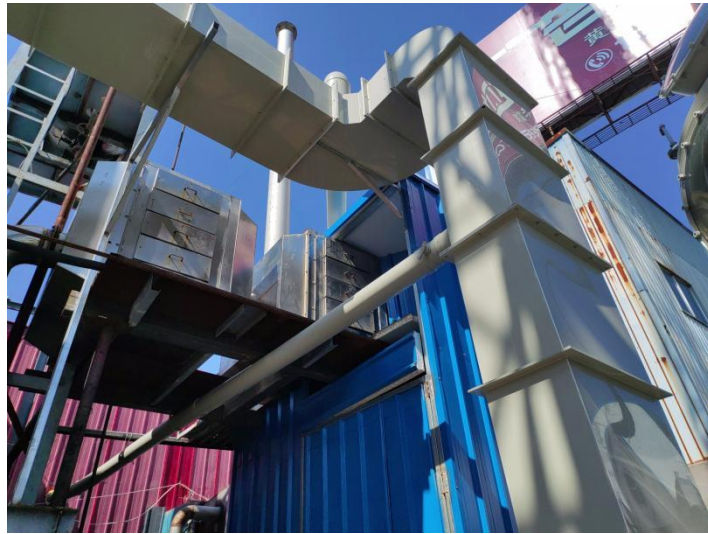
排气筒 DA001 (锅炉燃烧废气)
